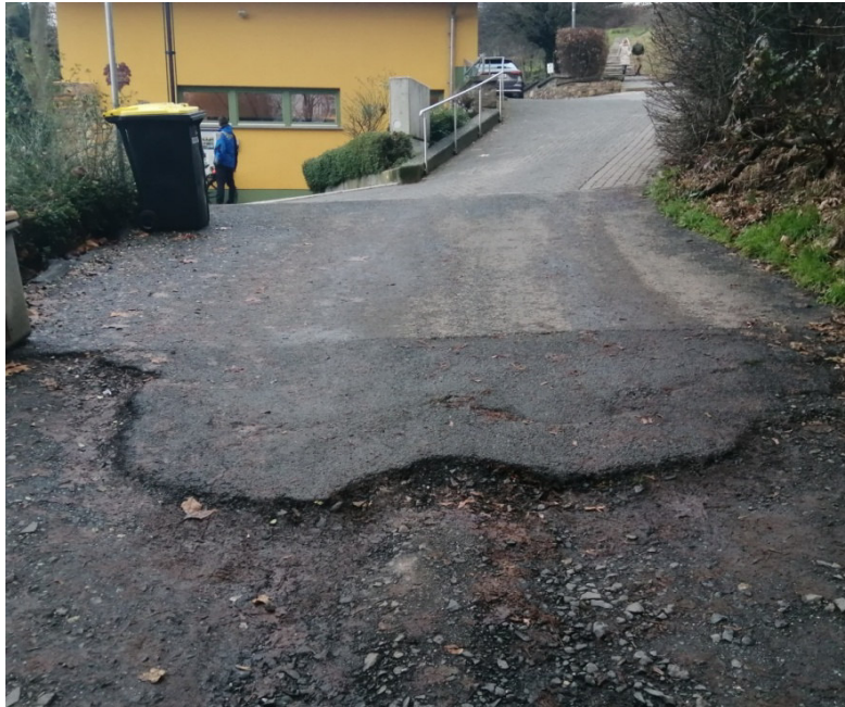
2020: Zufahrt zum Weinhaus in schlechtem Zustand
